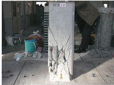
1 せん断破壊試験後、補修前状況 柱状供試体(製作時 N-02)
